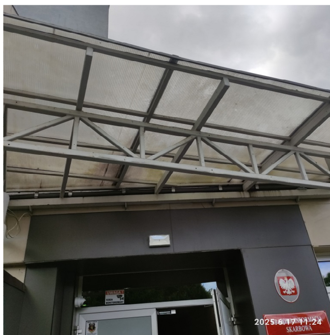
Fot. 4. Konstrukcja nośna dachu – stalowa belka przy ścianie zewnętrznej, drugi segment kratownicy
