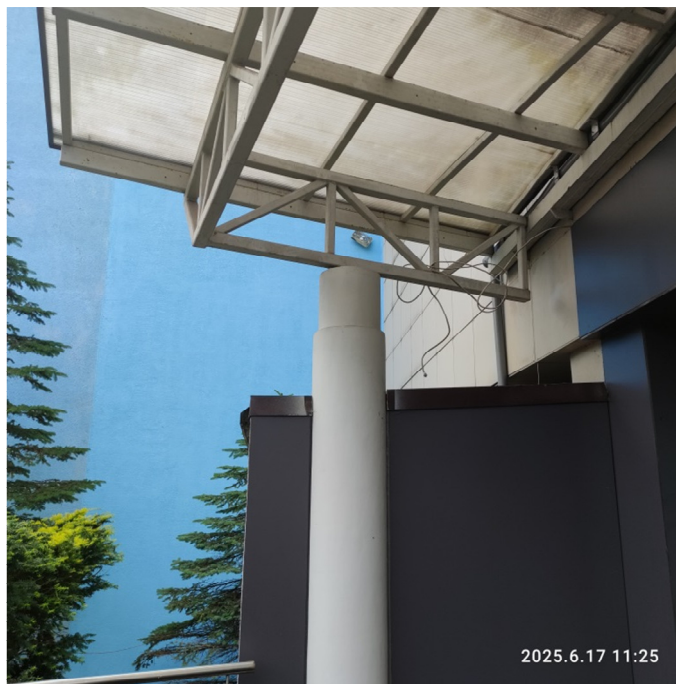
Fot. 3. Konstrukcja nośna dachu – słup o skokowo zmiennej średnicy, stalowa belka przy ścianie zewnętrznej, połączenie dwóch segmentów kratownicy
