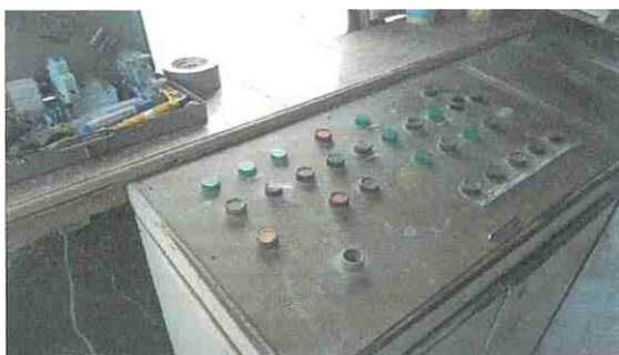
Fot. 5 —węzeł betoniarski ZREMB B303
