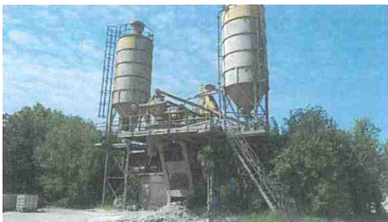
Fot. 1— węzeł betoniarski ZREMB B303
