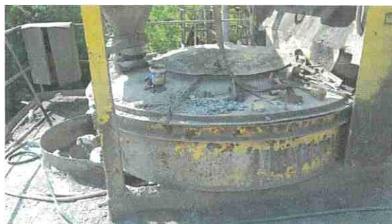
Fot. 4—węzeł betoniarski ZREMB B303
