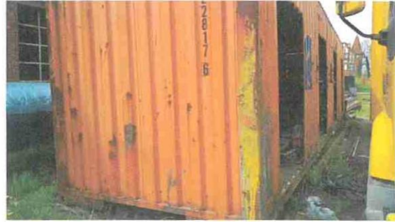
Fot. 160 — kontenery morskie
